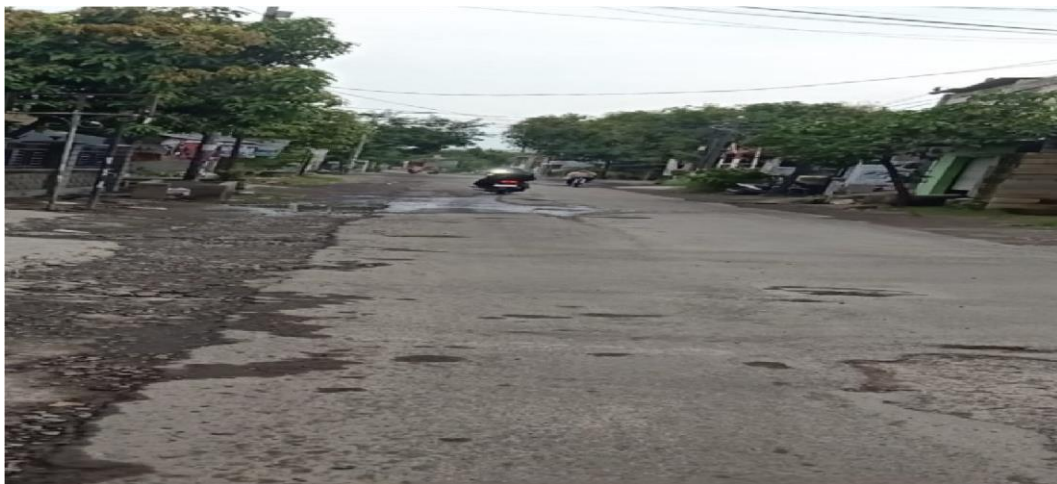
Gambar.1. Jalan Rusak arah menuju fasilitas umum
